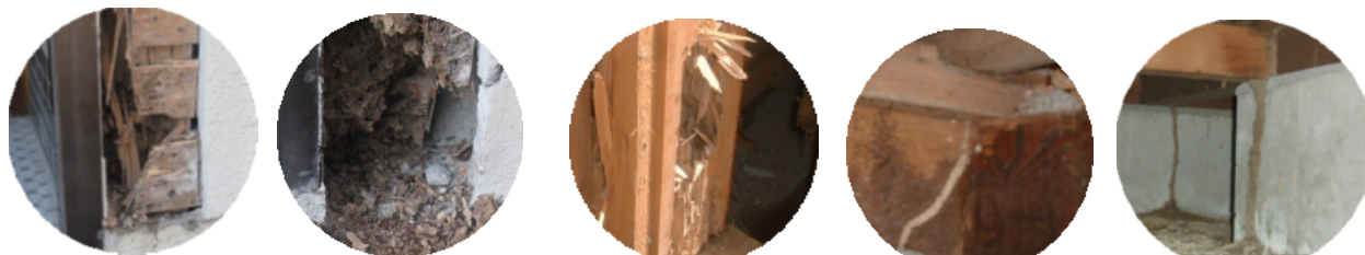
↑ 食害された玄関先の外壁内の木部 ↑ 内部を食害された柱 ↑ 床下の蟻道（アリの通り道）
